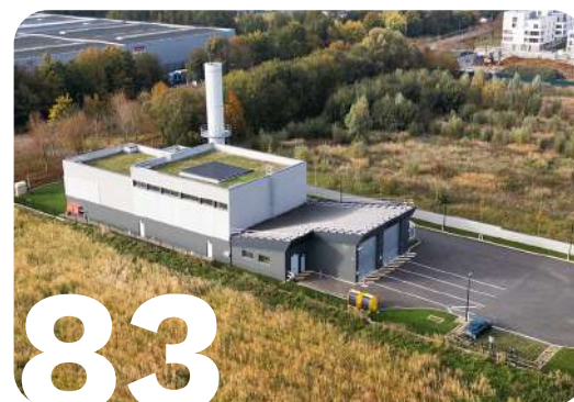
83 Réseaux de chaleur et de froid
